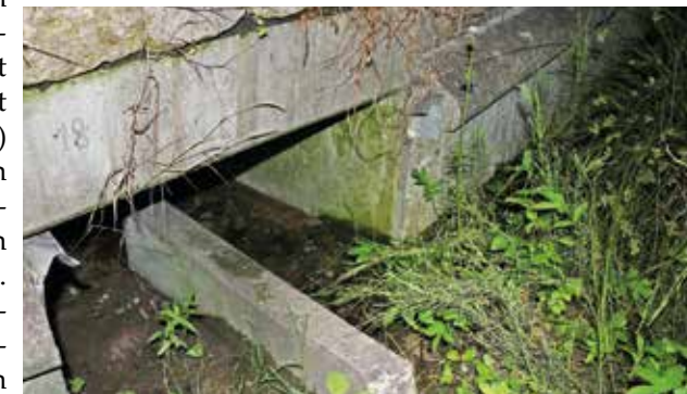
Dauerhafte Amphibienschutzanlage mit einem Durchlass unter der Straße
